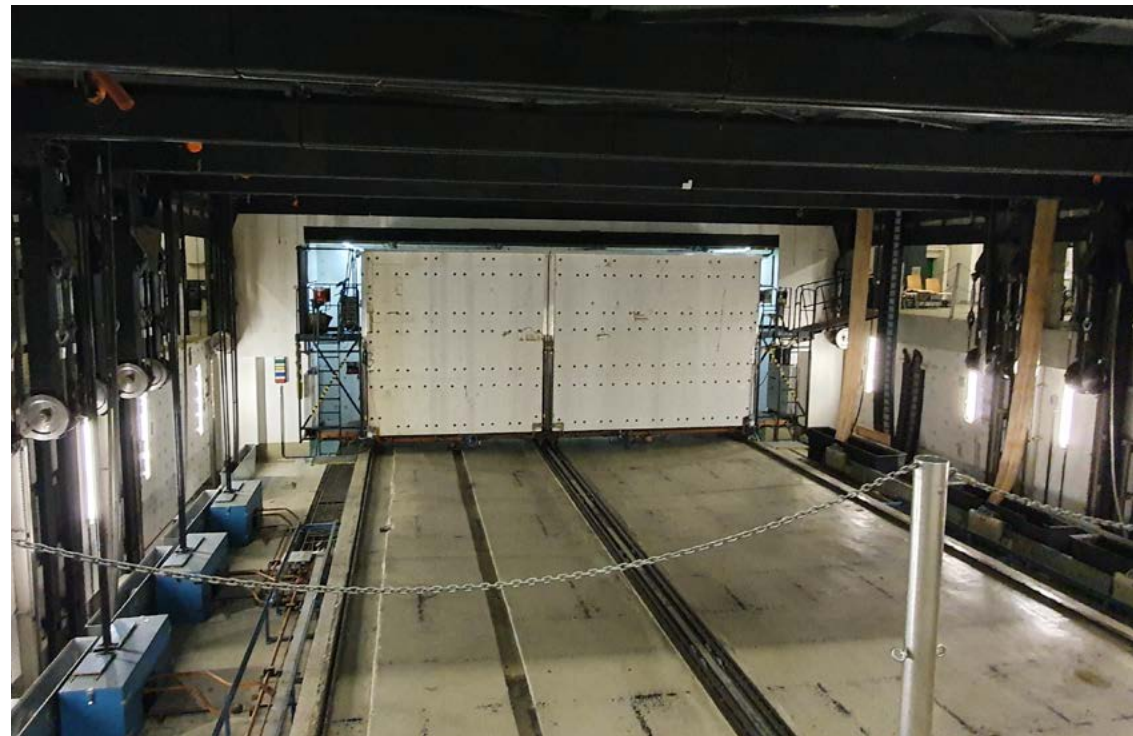
Unter der Bühne: Die Hydraulisch angetriebenen Hubpodien (© Maximilian Overesch)
